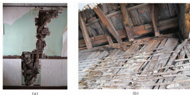
Figura 5 - Alguns danos em estruturas de madeira: (a) Ataque de fungo xilófago em parede de frontal; (b) Ataque de insectos xilófagos (caruncho) em elementos de cobertura.
