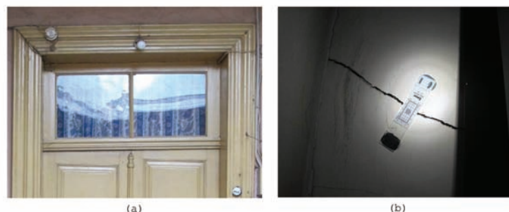
Figura 3 - (a) Deformação de vão interior resultante de assentamento ao nível das fundações; (b) Monitorização de fissura através da instalação de...
