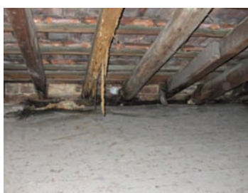
Figura 5. Danos identificados em elementos estruturais: (c) cobertura
