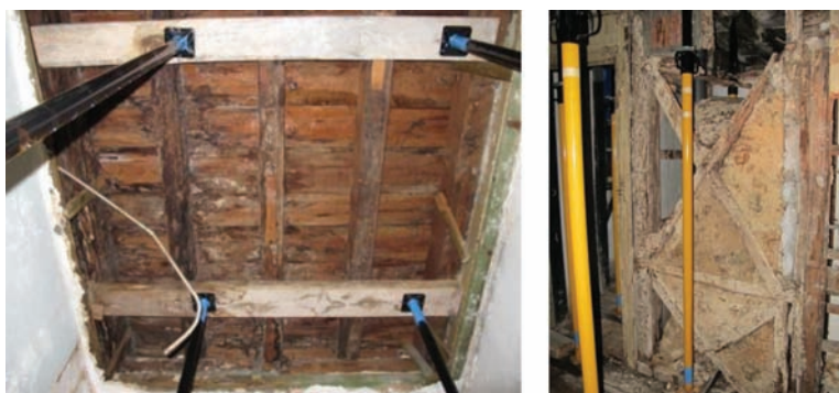
Figura 5. Danos identificados em elementos estruturais: (a) pavimentos; (b) parede de frontal;
